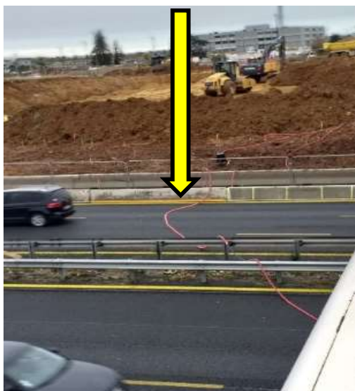
Gaine sur la chaussée de l'autoroute
